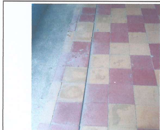
Foto 2: piso dañado en la parte del corredor
