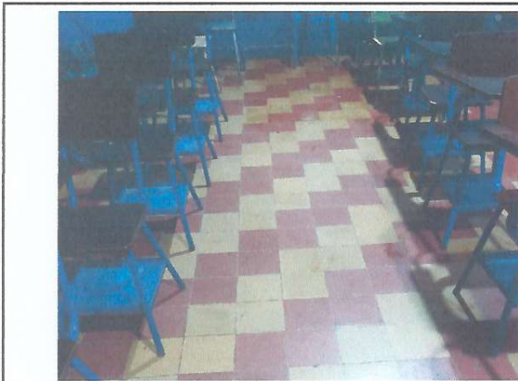
Foto 3: Piso de las aulas en deteriorio
